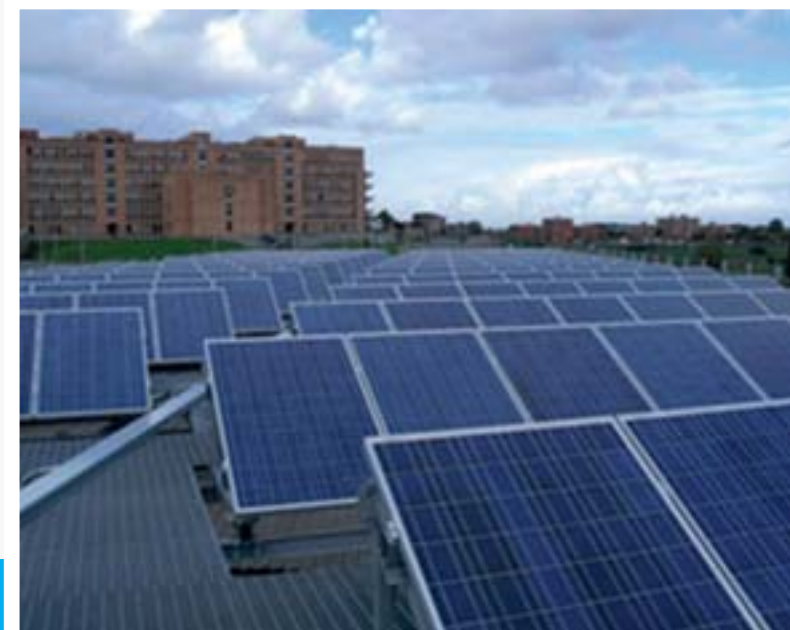
Impianti fotovoltaici, nuova fonte energetica ecologica ubicati presso una caserma Photovoltaic systems, new energy source label located at a barracks.
